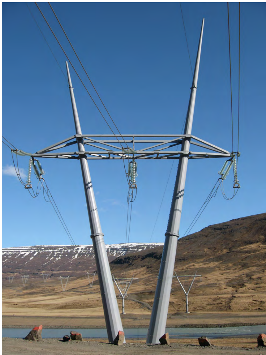
Mynd C. Mastur við Fljótisdalsstöð. Útlitshönnun Hornsteinar arkitektar.
